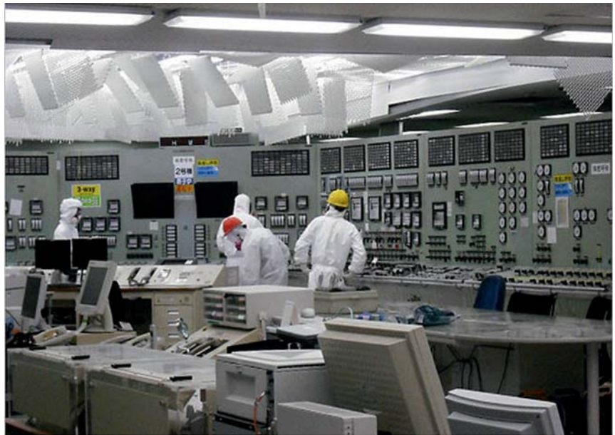
Recuperación del suministro proveniente del exterior a las unidades 1 y 2 y del suministro a la sala de control de la unidad 2 el 26 de marzo de 2011. Las placas del techo quedaron colgando como consecuencia del terremoto. Fuente: Tepco.
